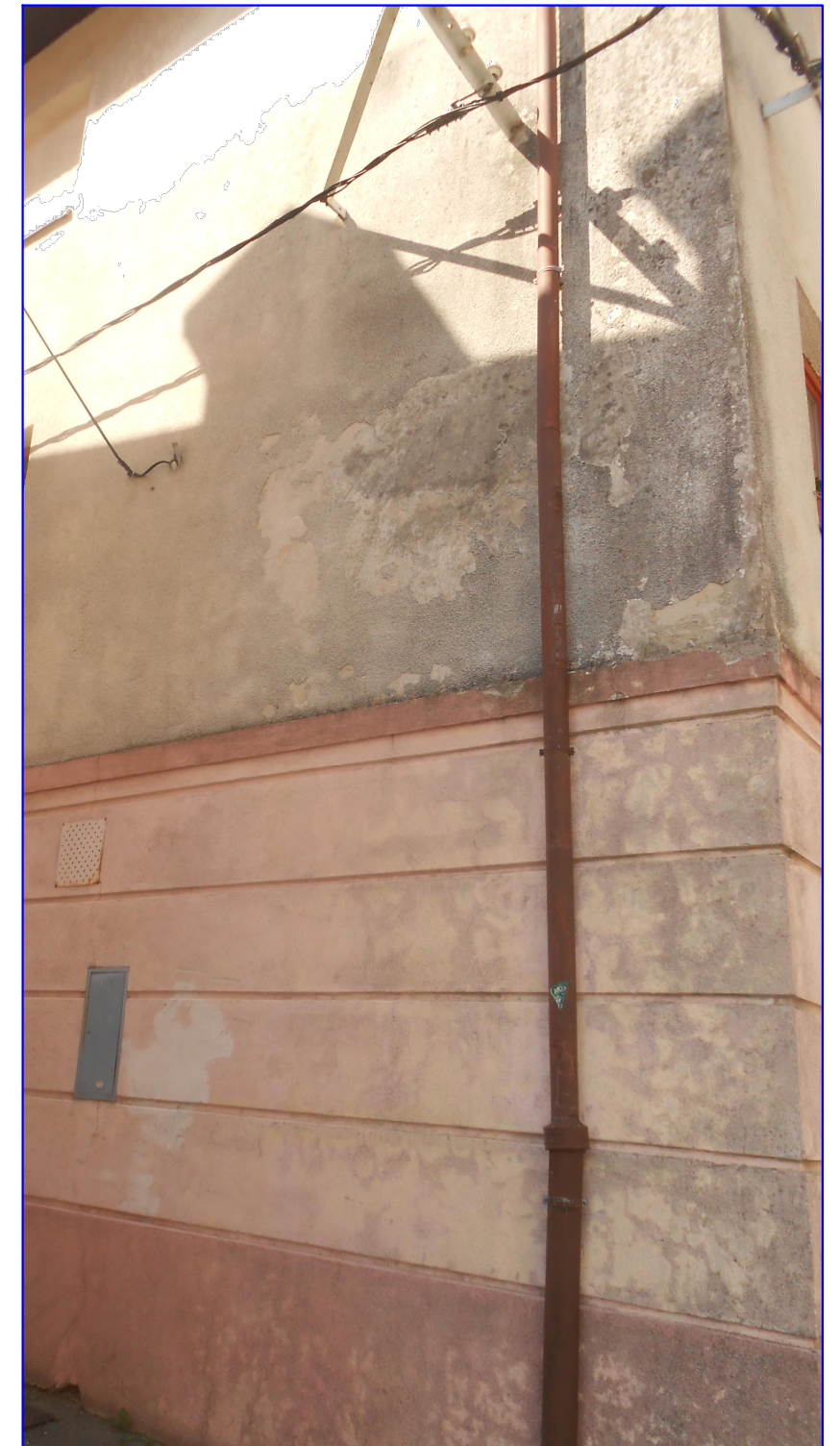
Mrežaste razpoke ometa severovzhodne fasade
