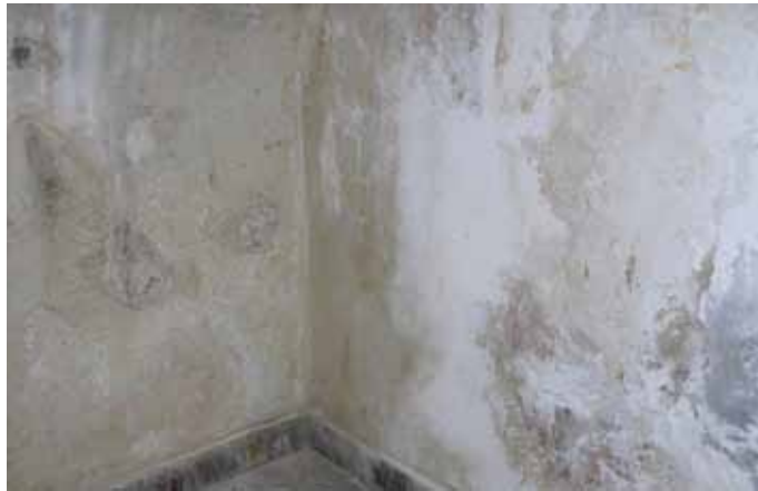
Eflorescenca na apneno cementnem ometu opečnega zidu
