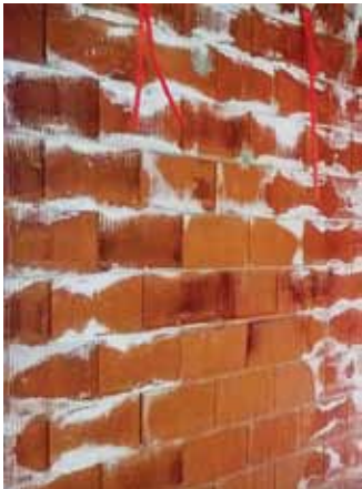
Eflorescenca na opečnem zidu
