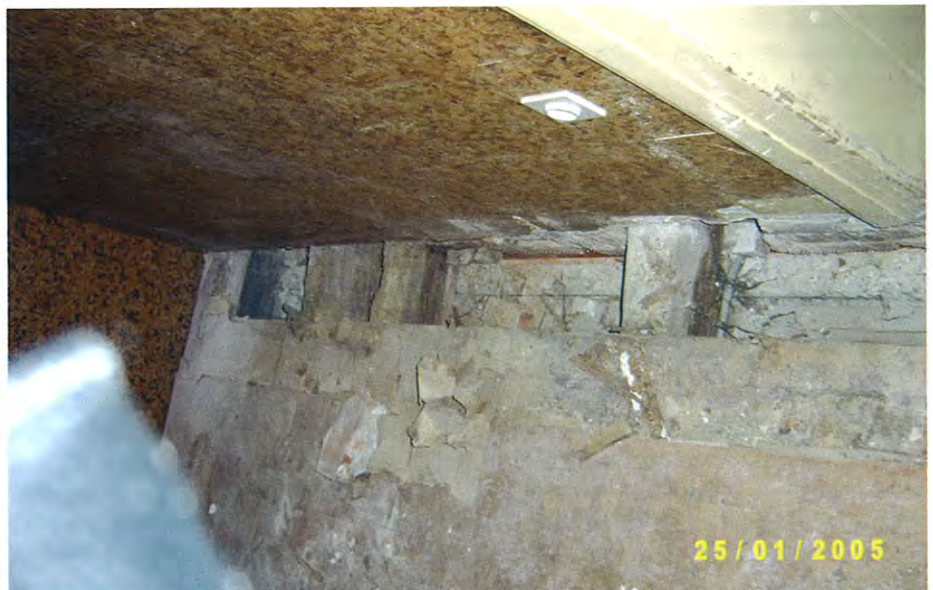
Slika 14 • Po odstranitvi zaključnih paroneprepustnih slojev tudi sicer popolnoma nestrokovno izvedenega sovprežnega estriha brez ustreznega sidranja so vidni prhli stropniki
