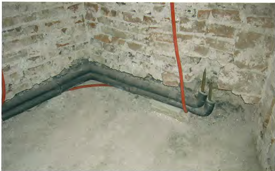
Slika 15 • Primer nedopustnega posega: horizontalni inštalacijski utor globine 30 cm pomeni izrazito oslabeitev zidu, ki lahko privede do porušitve (ekscentričnost) že pri nižjih obremenitvah, da o potresni varnosti niti ne govorimo
