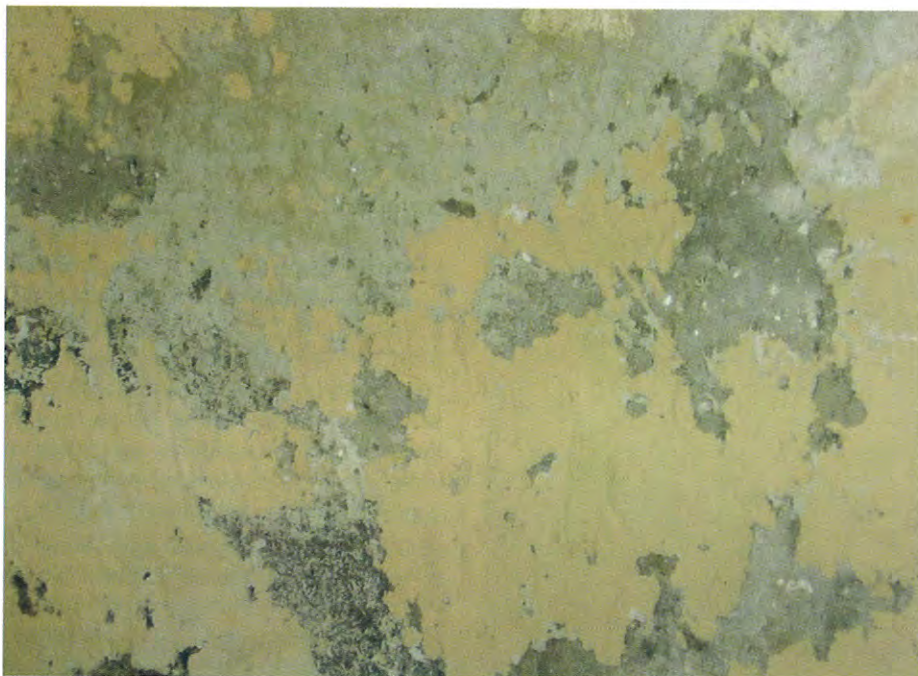
Slika 11 • Poškodbe ometa injektiranega zidu, do katerih je prišlo zaradi prekratkega časa sušenja zidu v zimskem obdobju
